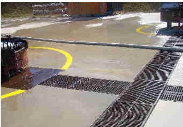
Figura 16 – Vista das canaletas para recuperação da água
