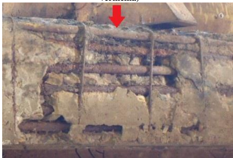
Figura 14 – Patologia química: exposição e corrosão das armaduras da viga (seta vermelha)
