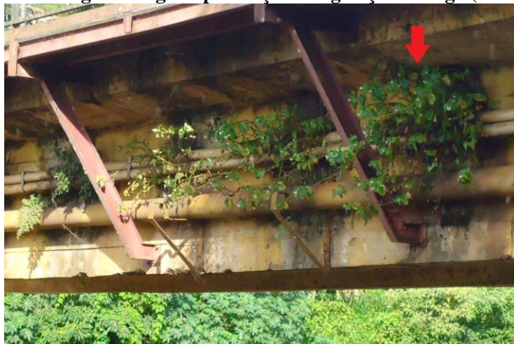
Figura 13 – Patologia biológica: presença de vegetação na viga (seta vermelha)
