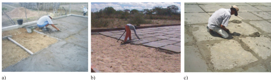
Figura 3. Produção de calçadão de concreto: a) Utilizando junta de dilatação; b) Utilizando placas de concreto; c) rejunte das placas
