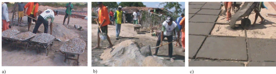
Figura 5. Produção do concreto: a) dosagem em volume; b) mistura manual; c) lançamento
