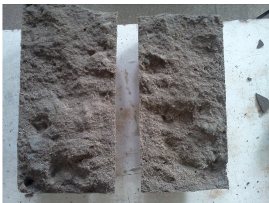
Figura 6. Superfície de ruptura por compressão diametral do concreto moldado em campo
