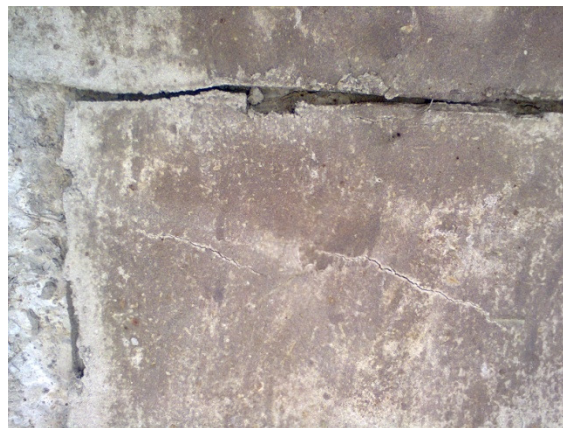
Figura 7. Fissura por retração em placa de concreto do calçadão
