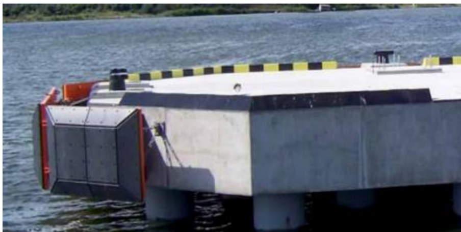
Figura 7. Defesa utilizada em dolfim de atracação (Fonte: Fender Team, Catálogo de Produtos).
