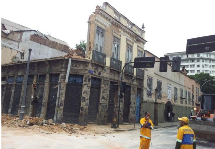
Figura 1 – Desabamento na Lapa. A construção está localizada na esquina das Ruas do Lavradio e da Relação. Fonte: SINPOL, 2012.
