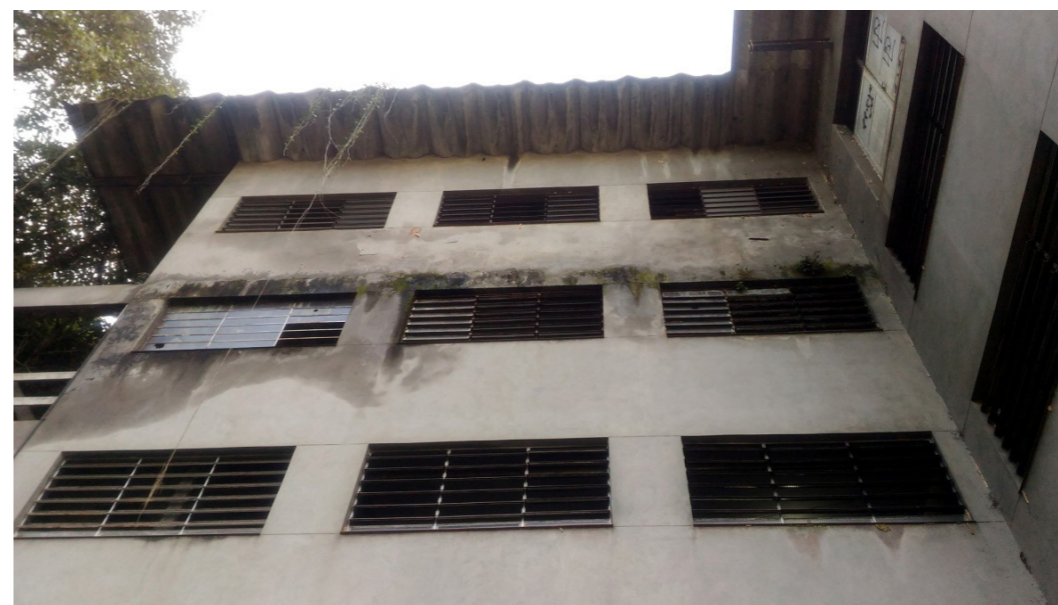
Figura 1 – Fachada da Fábrica abandonada da Batata James, Petrópolis, RJ
