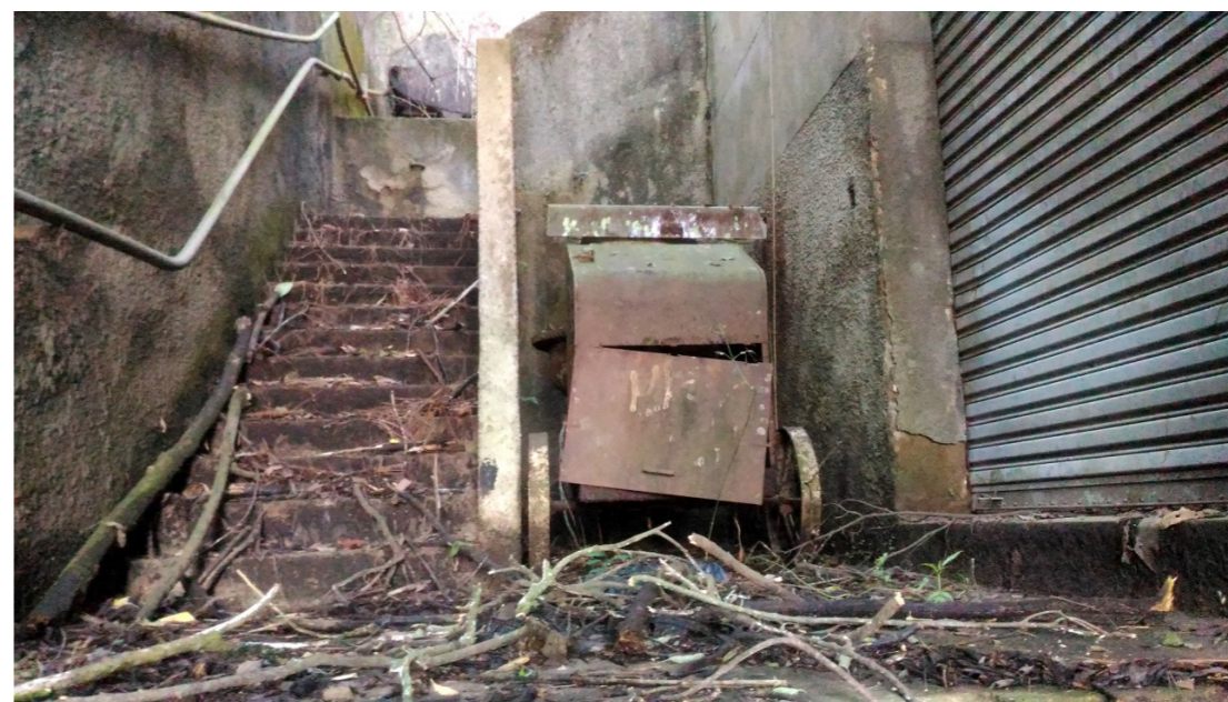
Figura 2 – Escada de acesso ao terceiro andar do edifício com equipamento abandonado, Petrópolis, RJ
