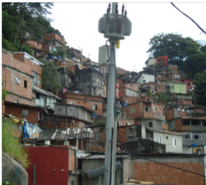
Figura 2: Novos transformadores de energia.
