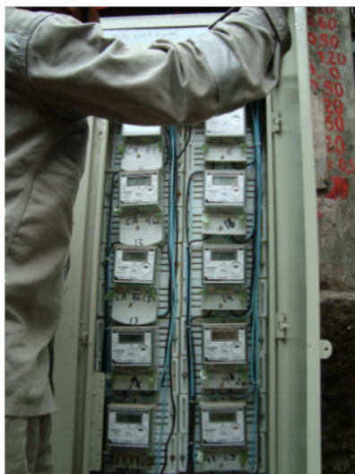
Figura 3: Medidores de energia em gabinete blindado.
