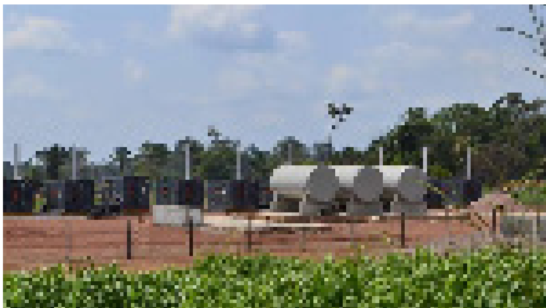
Figura 6 – Usina Térmica de Vista Alegre do Abunã
