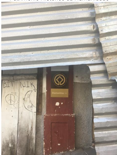
Figura 5 - Placa em edificação deteriorada com tapumes metálicos, com indicação do reconhecimento de Diamantina enquanto Patrimônio Histórico da Humanidade
