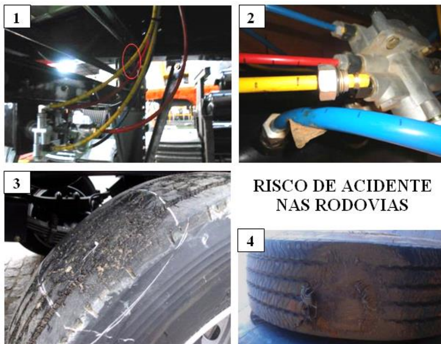
Figura 1: Estágios da instalação e escapamento das mangueiras do sistema pneumático
