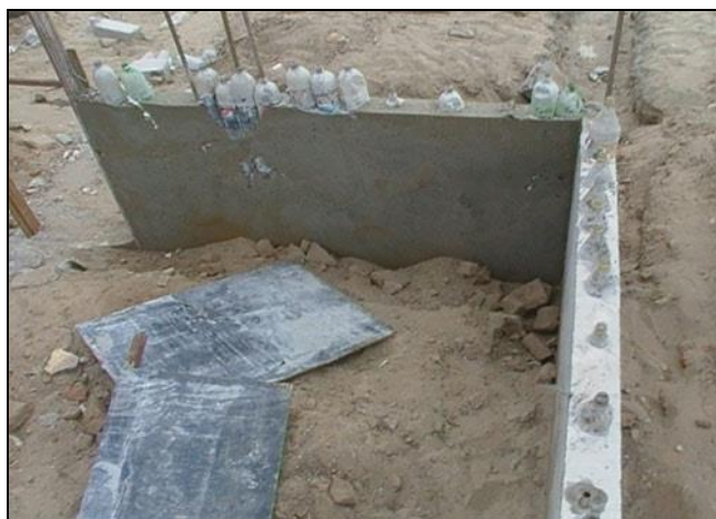
Figura 2: Etapas Da Construção Das Casas Populares com Garrafas PET Fonte: Portal Met@lica (2010).
